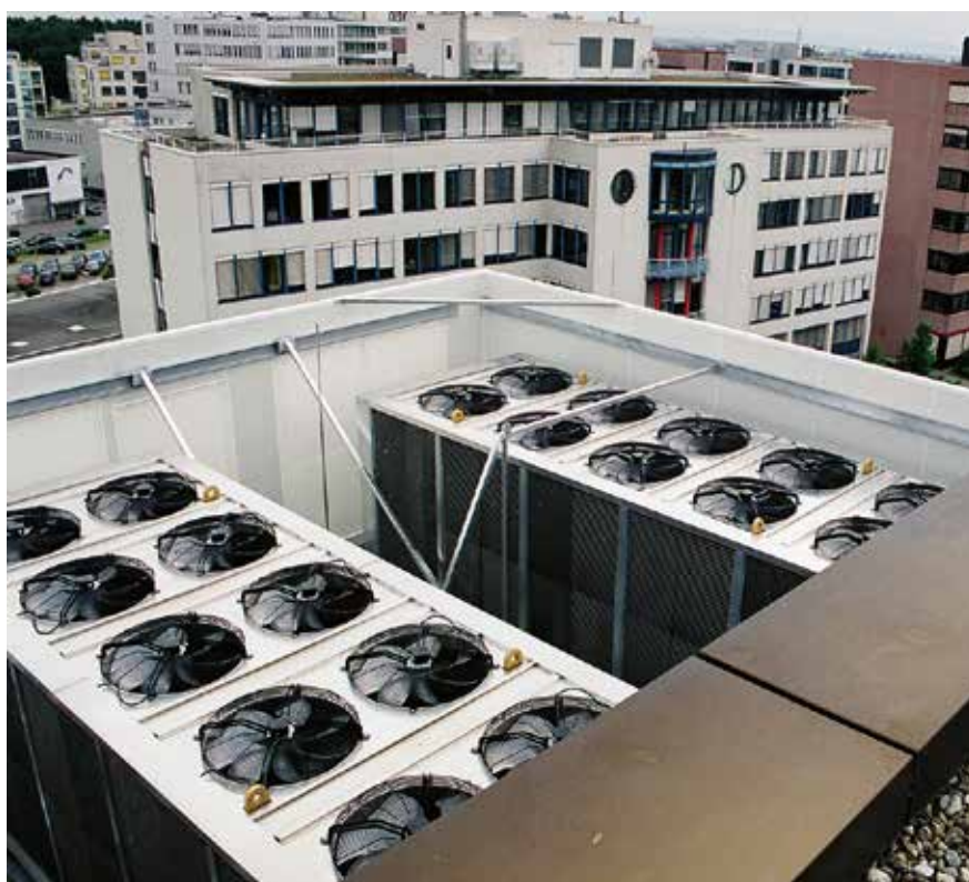
Bullerdämpning av kylmedelskylare, Stuttgart, Tyskland.
