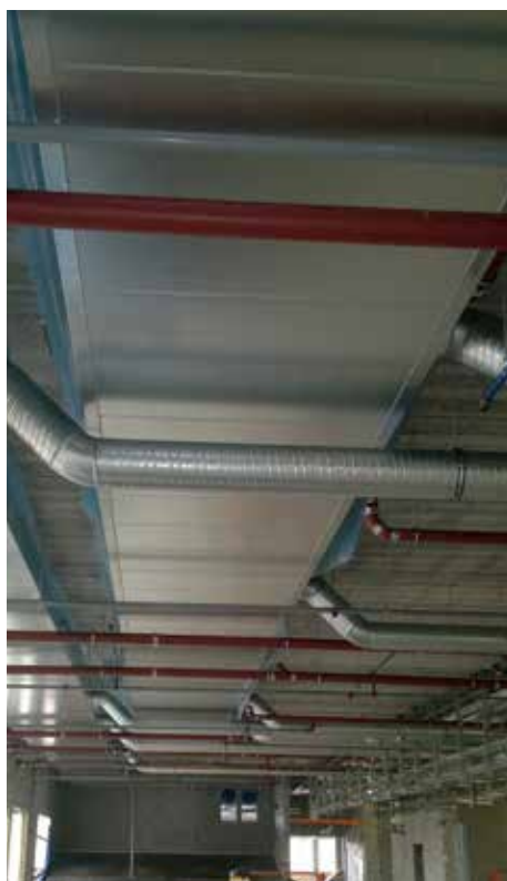
Ljuddämpande ventilationskanaler och schakt. Nya Karoliska sjukhuset, Solna, Sverige.
